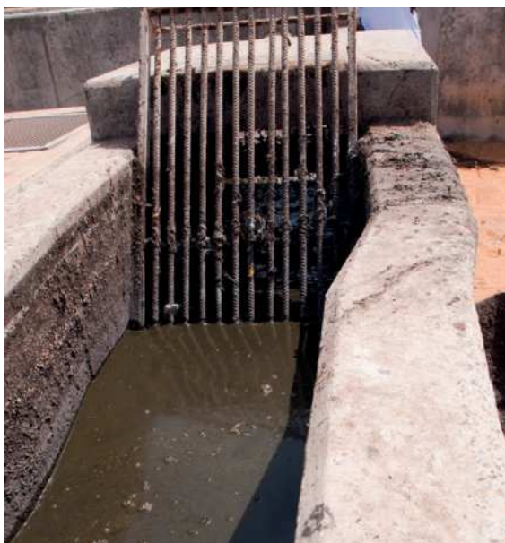
Figure 3.6 : Dégrilleur de la station de traitement des boues de vidange de Niayes, Dakar, Sénégal (photo : Linda Strande).
