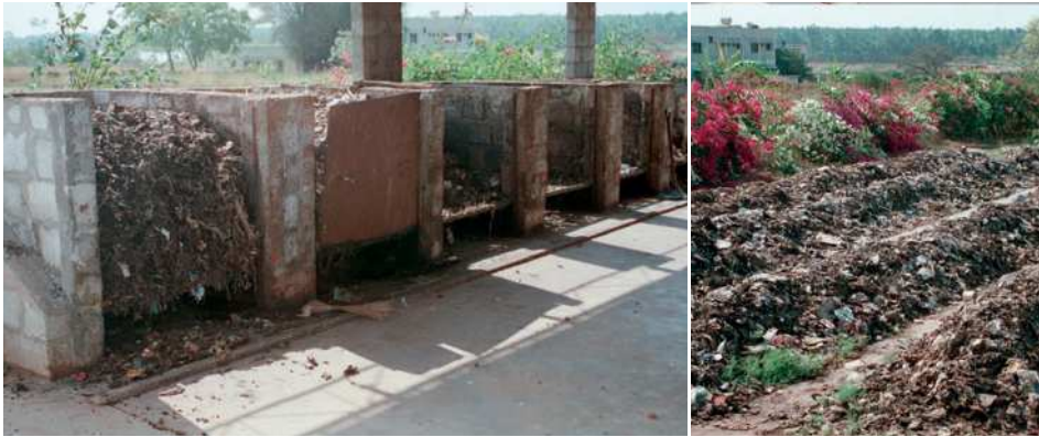
Figure 3.11 : Installation de cocompostage pilote avec des boues de vidange et des déchets municipaux à Bangalore, en Inde (photo : Chris Zurbrügg).
