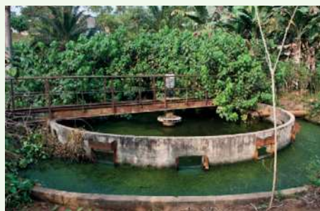
Figure 17.3 : Station d'épuration non-fonctionnelle à Yaoundé, Cameroun (photo : Linda Strande).
