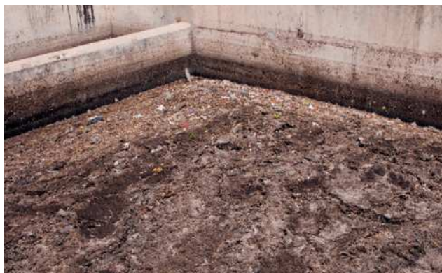
Figure 3.2 : Bassin de décantation de la station de traitement des boues de vidange de Dakar, Sénégal (photo : Linda Strande).
