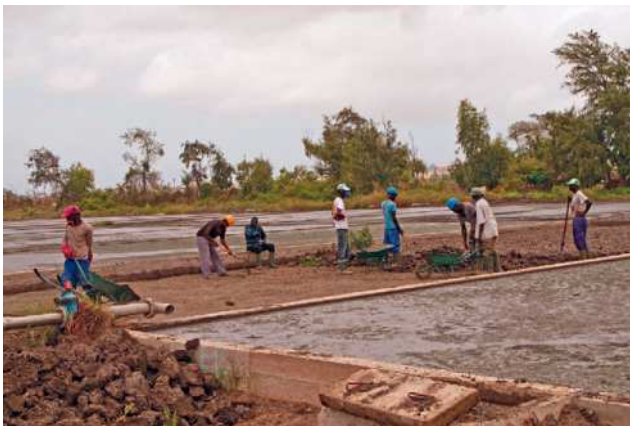
Figure 12.2 : Curage des boues de lits de séchage pour réutilisation en agriculture, Dakar, Sénégal (photo : Linda Strande).
