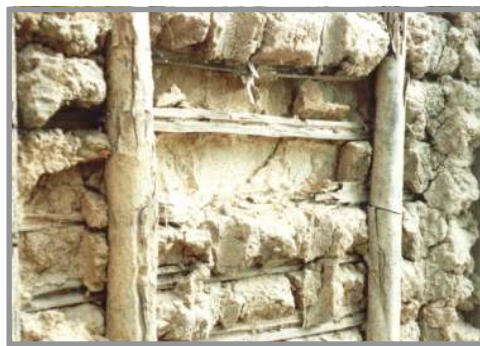
Figura 14: pau-a-pique (Cidade de Goiás, GO). Fonte: foto de Lourenço, L. A. B. (2001).
