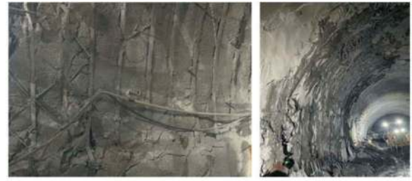
a) Longitudinal cracking
