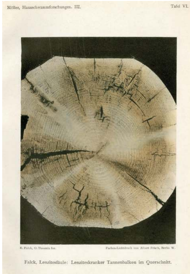
Abb. 72: „Lenziteskranker Tannenbalken im Querschnitt“. 1206
