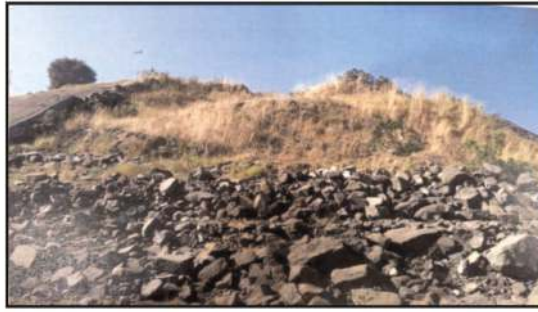
Figure 3. Distressed divide bund (Kapadia 2022).
